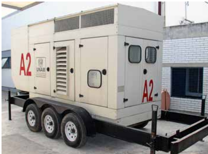
La FMVZ cuenta con planta eléctrica de emergencia para hospitales y laboratorios, entre otras áreas.
